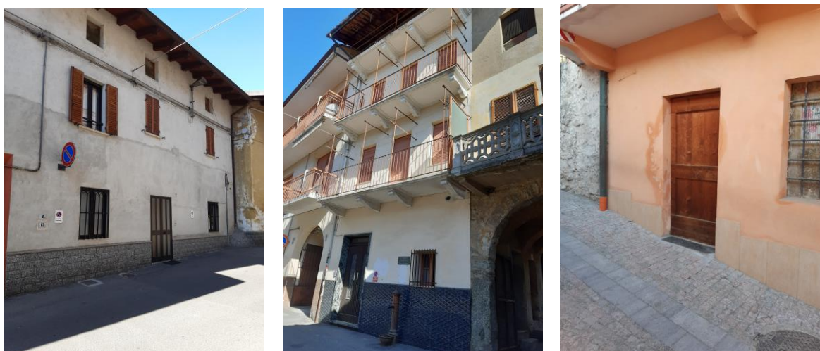
Figure17-18-19 – Esempi di zoccolature inadeguate
